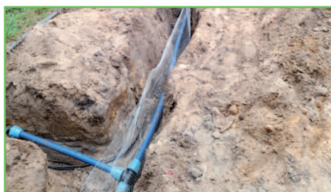
Beregnungsanlage mit ringsum verlaufenden, vertikalen Maulwurf-Schutzvorhang (Foto: John)
